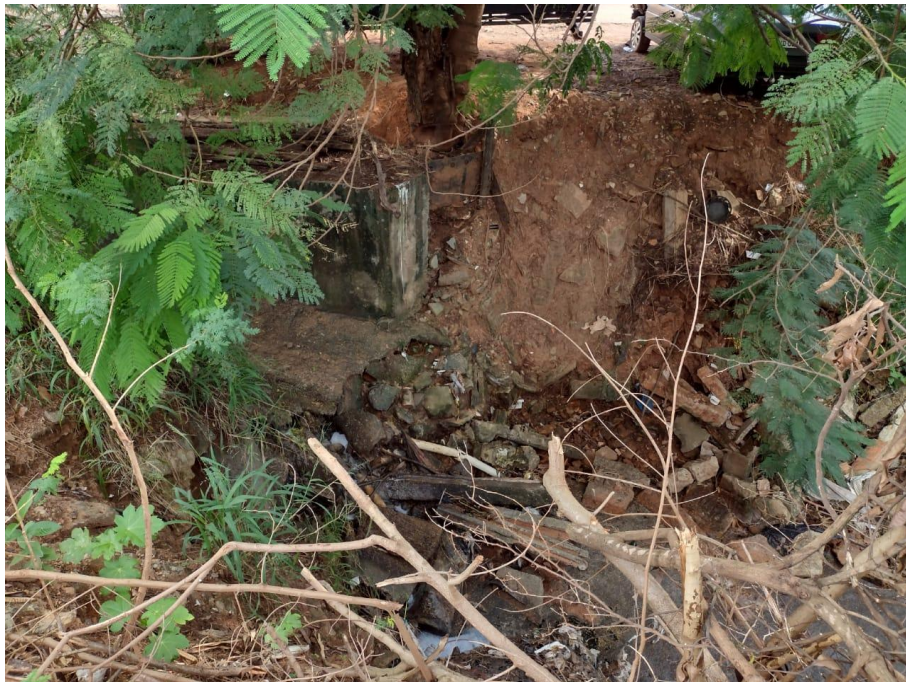
Figura 10. Demonstrativo do processo erosivo.
